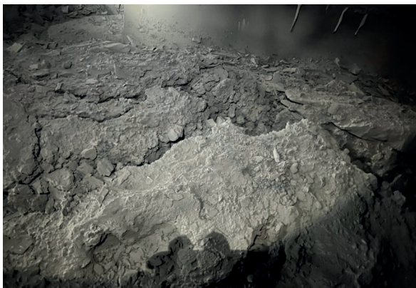
Рис. 2. Пример трещин в почве в вентиляционном штреке 214-с (20.05.2025) [создан авторами] Fig. 2. Example of cracks in the soil in the ventilation shaft 214-с (05/20/2025) [created by the authors]
