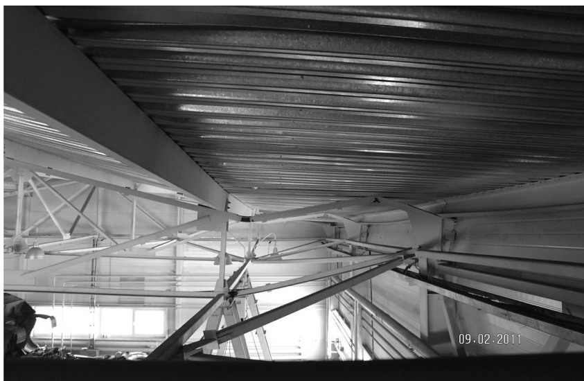
Рис. 1. Общий вид обрушения ферм
