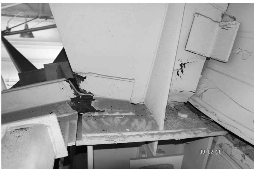
Рис. 2. Хрупкое разрушение нижнего пояса фермы
