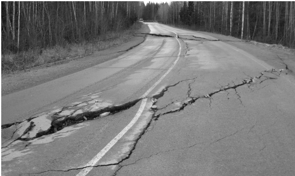
Рис. 2. Зона обрушения от отработки Южной залежи
