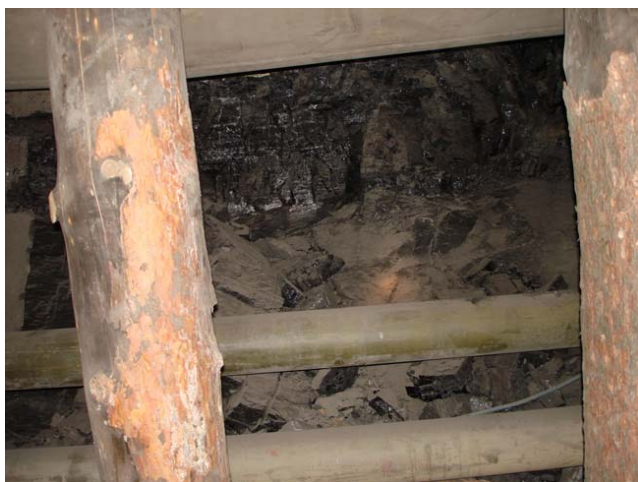
Рис. 2. Раскрытия трещин в нижней части выработки
