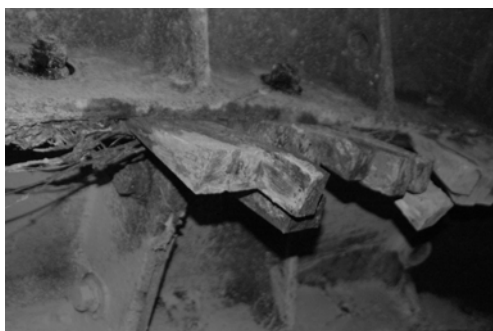
Рис. 2. Разрушение тубинговой крепи
