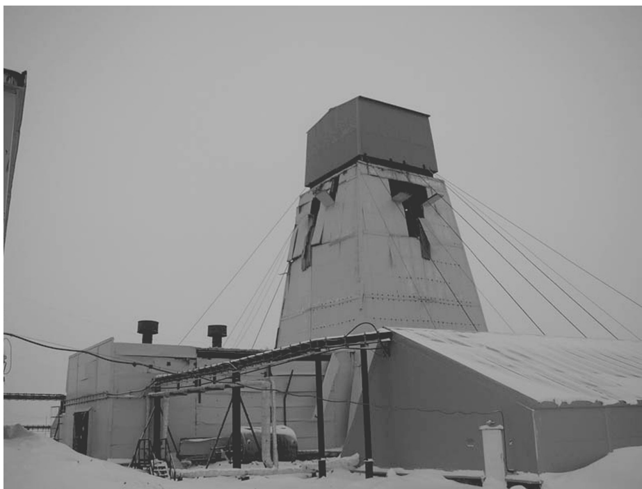
Рис. 2. Деформации обшивки копра
