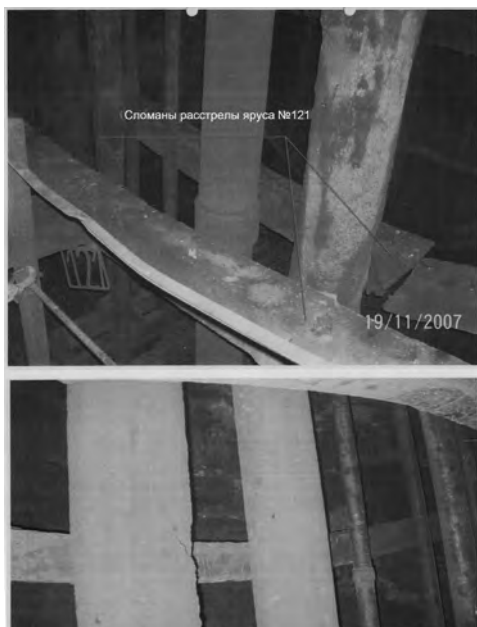
Рис. 2. Разрушение армировки ствола № 3 рудника БКПРУ-2 (2007 г.)
